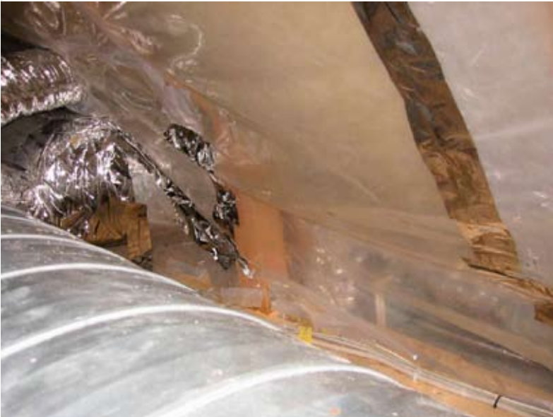
Tapet samling uden fast underlag – og tvivlsom tætning ved gennemføringer og spær.
