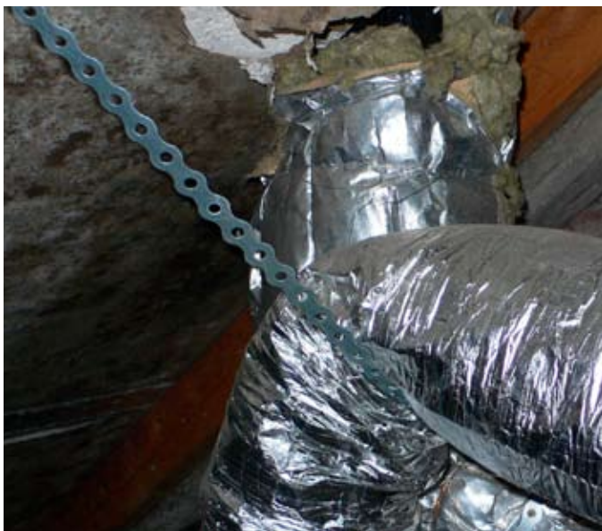
Utæt dampspærre har resulteret i skimmelvækst på undertag af gips.
