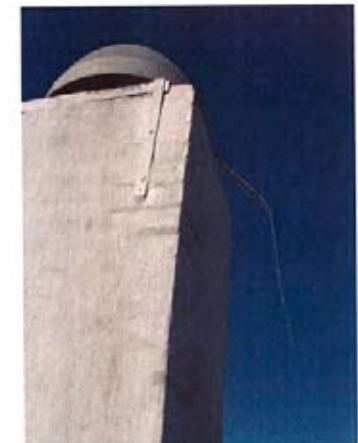
billed 5 Skorsten: løst beslag fjernes/fastgøres
