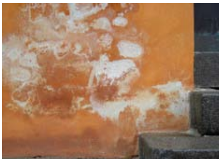
Saltudfældninger i facade
