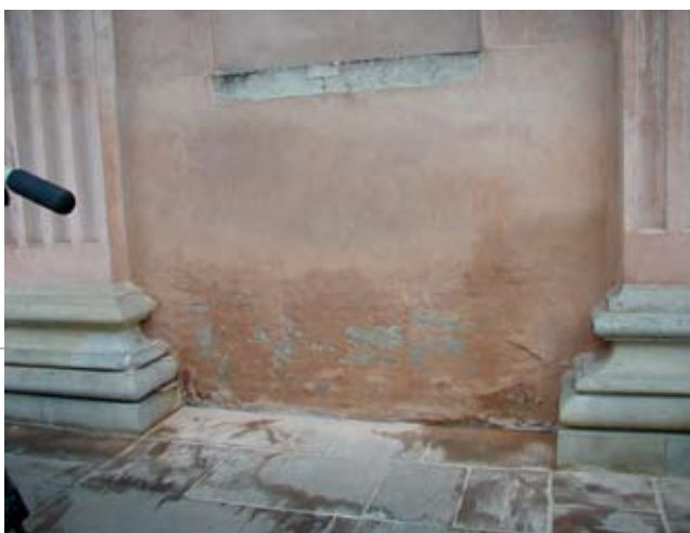
Øverst: Saltudfældninger i facade.
