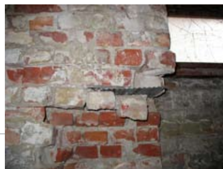
Eksempel på skade efter indvibrering
